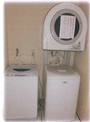
洗濯機・乾燥機
